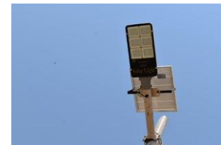
設置された安全灯
